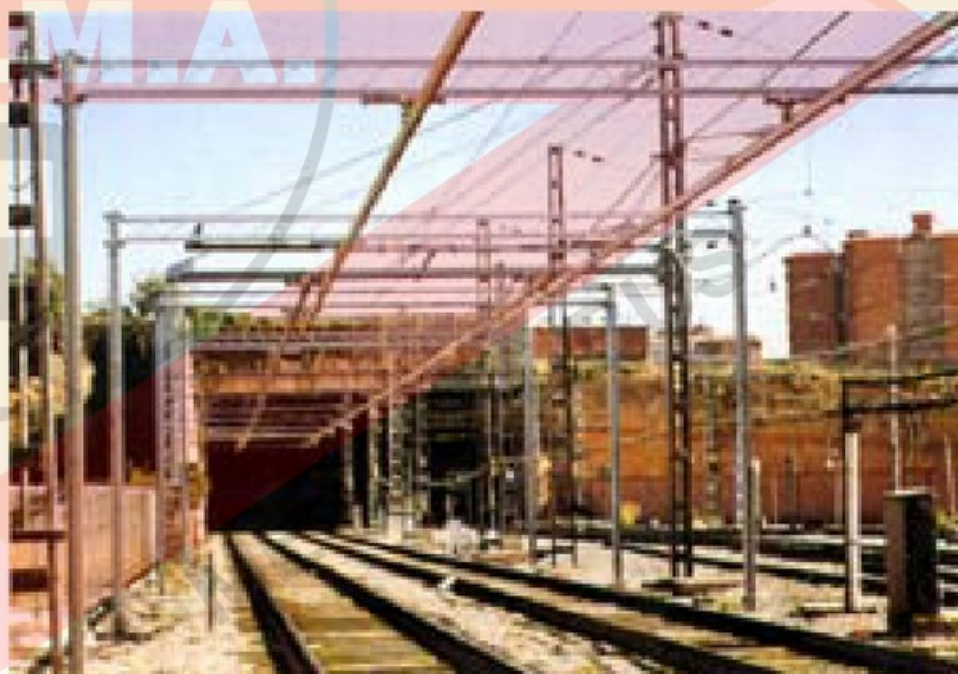
Detalle instalación catenaria rígida en Boixeres.
